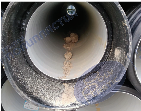
Рисунок 6 – Посторонний предмет в трубе
