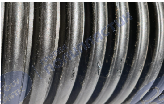
Рисунок 10 – Допустимые повреждения наружного слоя – царапины
